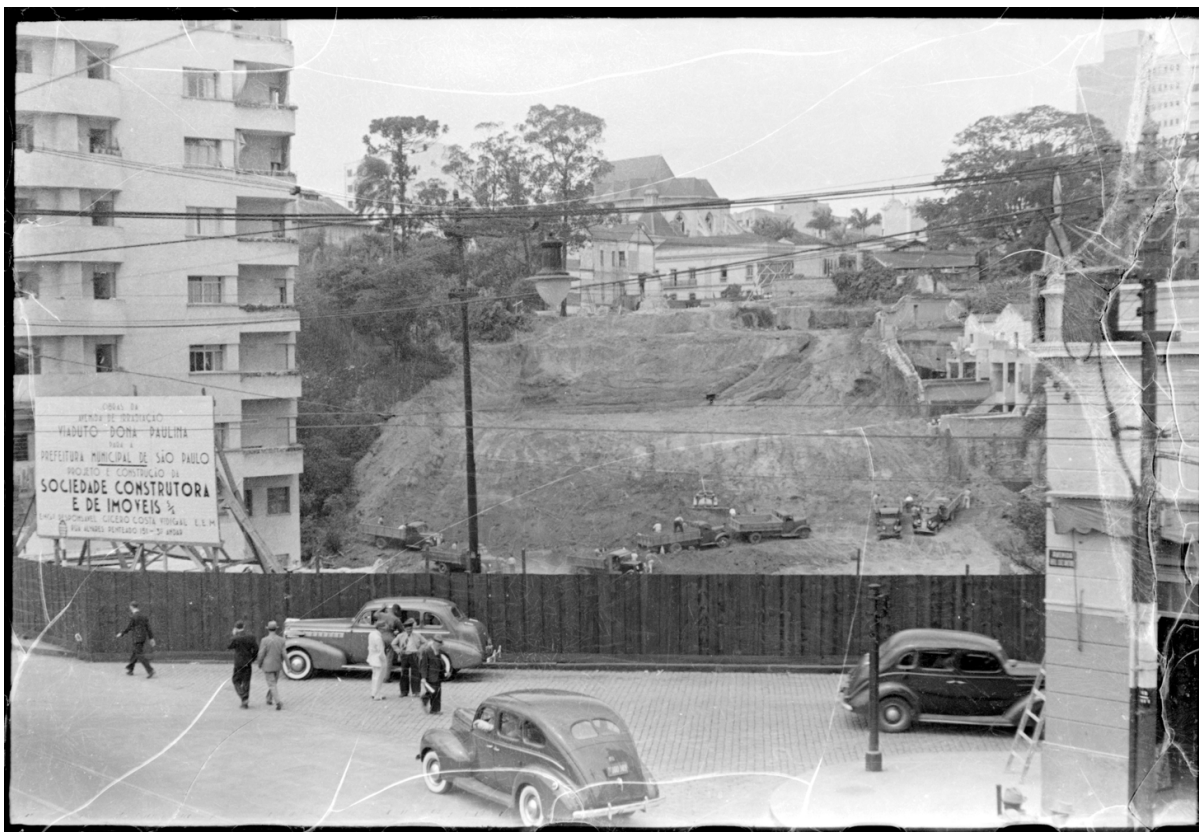
Figura 9. Fotografia registra a construção de Viaduto: Dona Paulina, esquina mais próxima: Maria Paula. DUARTE, Benedito Junqueira (BJ Duarte). Acervo Fotográfico do Museu da Cidade de São Paulo, 1941.
