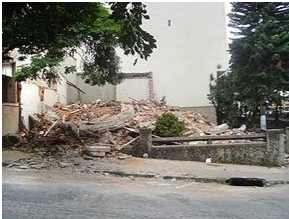
Figura 123. Demolição do Casarão da Rua Delfim Moreira. Foto retirada em 1985 por Ramon Brandão. Disponível em:
