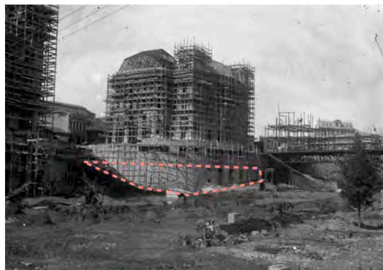
FIGURA 4.35 - Obras de construção dos palacetes Prates por volta de 1913. Em destaque rosa, a área aproximada que deveria ser encoberta pela saia de talude. Fotografia, P&B, Anônimo, Disponível em: Blog Sampahistórica. Acesso em 14.abr.2014.
