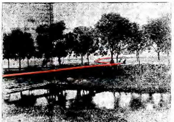
FIGURA 4.61 - Um trecho da Varzea do Carmo atravessada pelos tubos que conduzem terra do morro do Vergueiro para o aterramento daquelle local. 1911. No destaque, em vermelho, a tubulação. Acervo O Estado de S. Paulo
